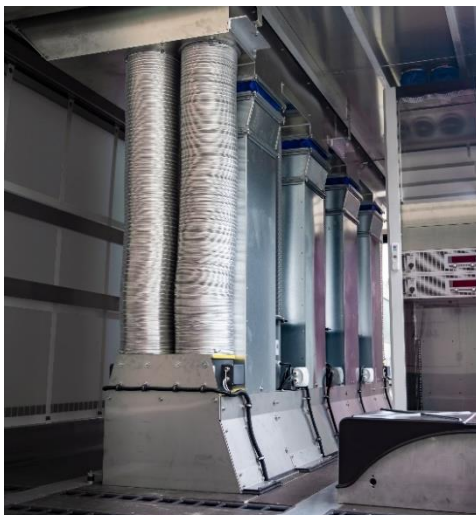
Zusatzkühlung über Fremdlüfter
